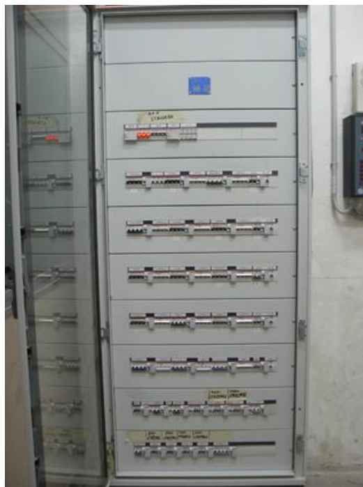
Figura 1 Vista del quadro elettrico
