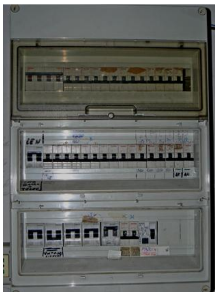
Figura 2 Vista del quadro elettrico dell'aula religiosa
