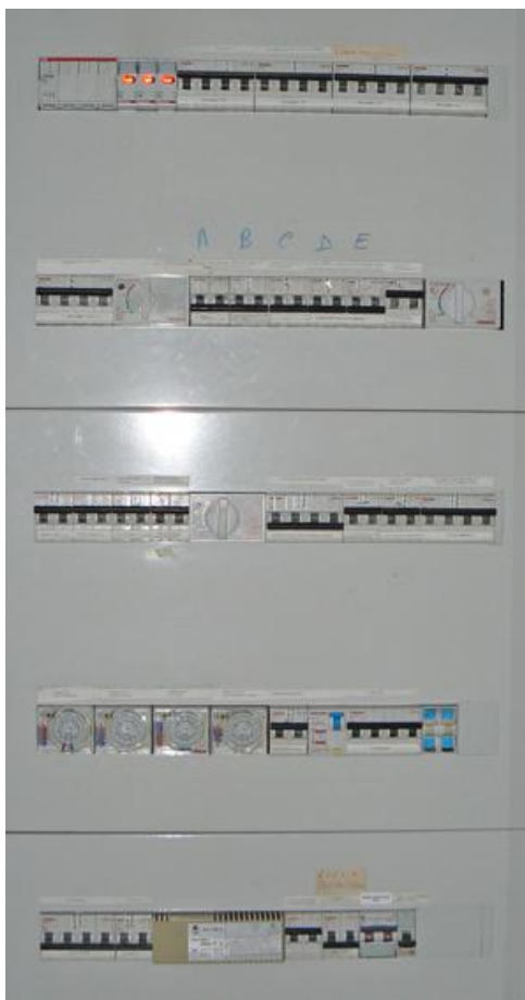
Figura 1 Quadro elettrico dell'aula religiosa e degli ambienti contigui
