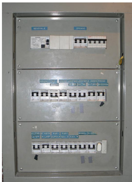
Figura 2 Vista del quadro elettrico dell'aula religiosa
